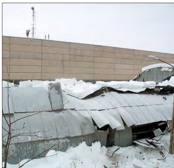
Обрушение крыши ангара в Южно-Сахалинске.
