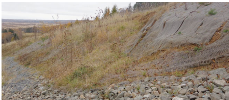
Рис. 4. Откос трассы нефтегазопроводов с оползневыми сдвигами. Неработающие кокоматы, время настила 4–5 лет назад. Фото С.П. Жируева
